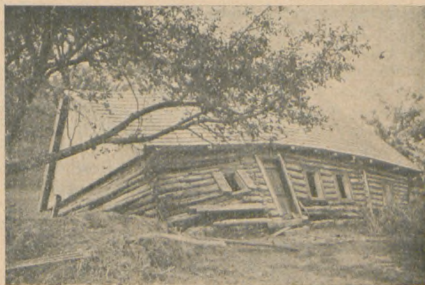
„Ocalały” budynek, naporem wody zdjęty z podmurówki, zatrzymał się o pobliską jabłoni.
